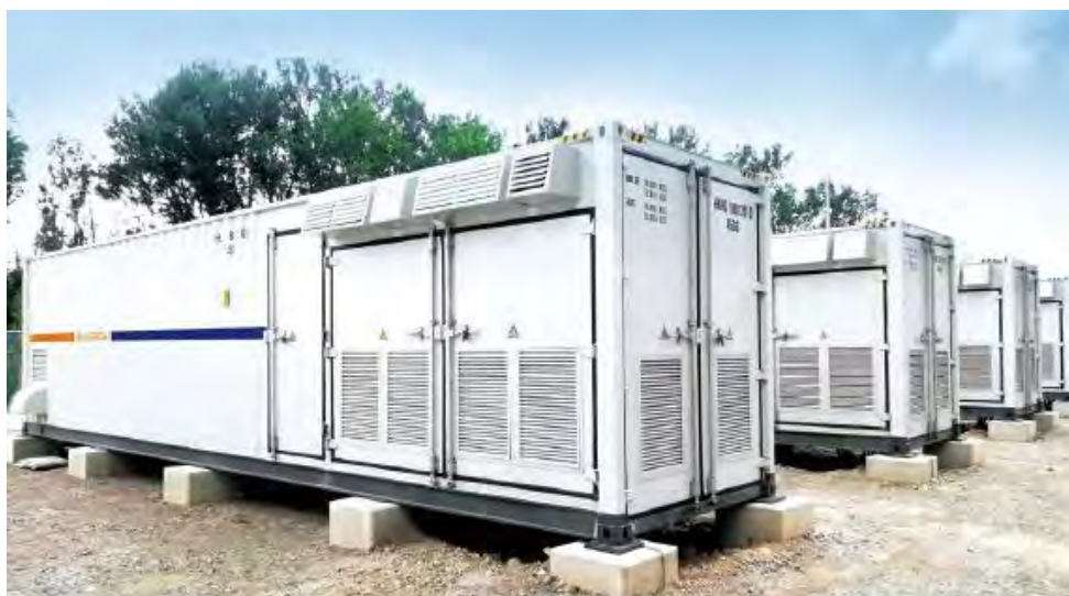
Foto: Eksempel på container med batterier.
