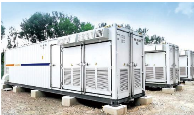
Figur 5: Eksempel på containere med batterier
