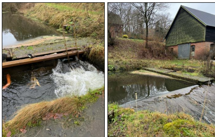
Figur 28: Tv. Indløb til Marshall Turbinen set i nordlig retning. Th. ses turbinebygningen og nødoverløb set i sydøstlig retning. (Billeder: Envidan)
