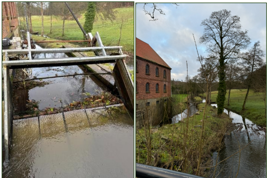
Figur 14: T.v.: Indløb, rist med selvrensende/automatisk rengøring, til turbinen ved Hopballe Mølle. T.h.: De to forløb fra den opstemmede sø, hvor den ene ledes igennem turbinen, og det andet løber udenom set fra Hopballevej i nordøstlig retning. (Billeder: Envidan).
