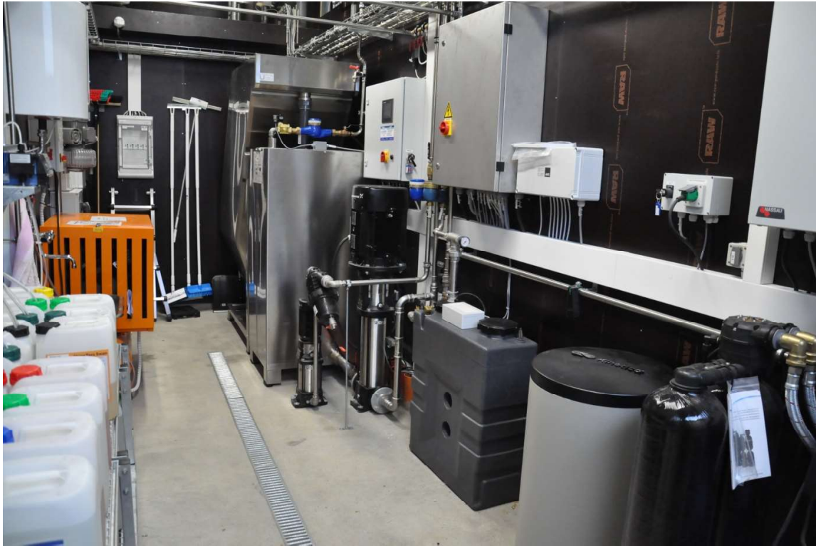
Fig. 2.2 Teknikrum med Bio Classic vandrensningsanlæg
