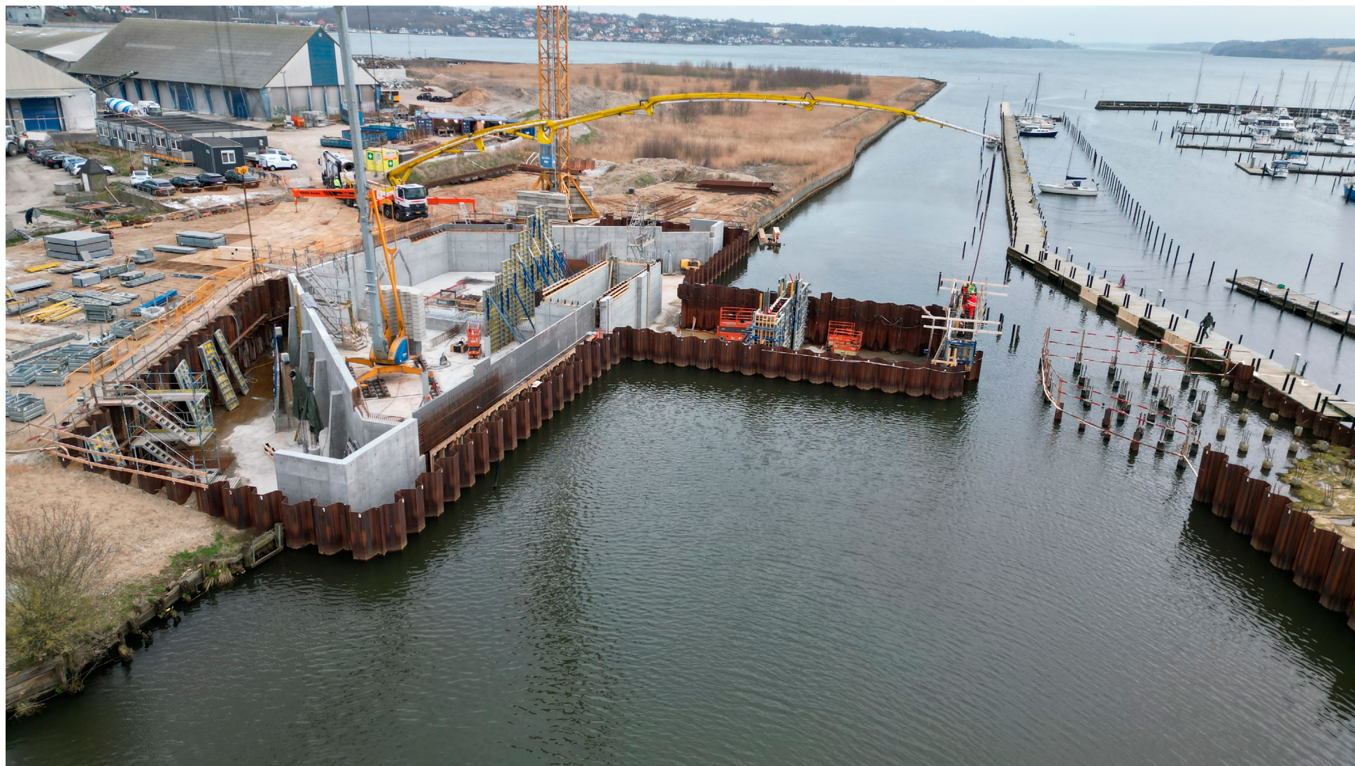
Byggegruppe – sluse-pumpeanlæg – Kilde Kolding Kommune.
