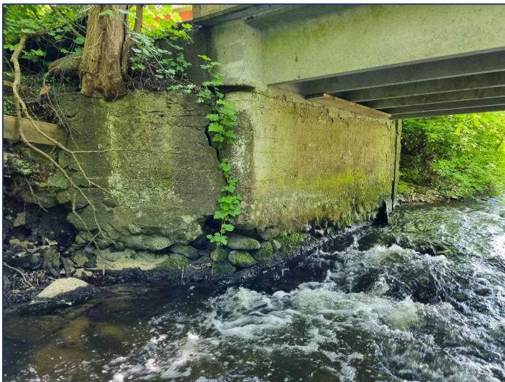
Figur 2: Eksisterende forhold. Endeunderstøtninger forvitret, sydvestlig fløjvæg knækket af.
